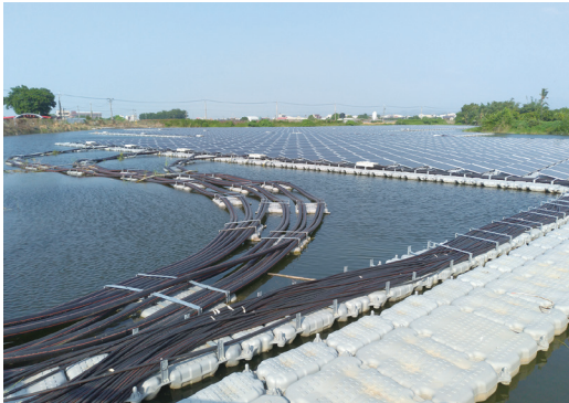
瓦磘埤設置水面型太陽能光電系統
