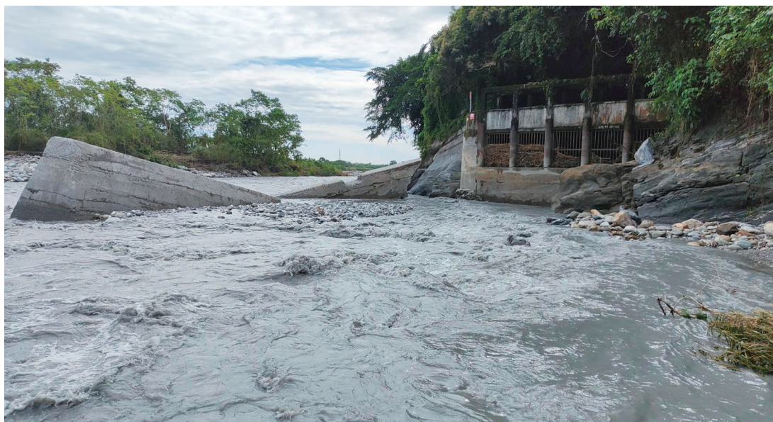
志學圳進水口兩側土堤遭大水沖毀
