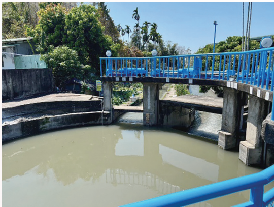
圖3 南投管理處-大圳五汙制水閘門
