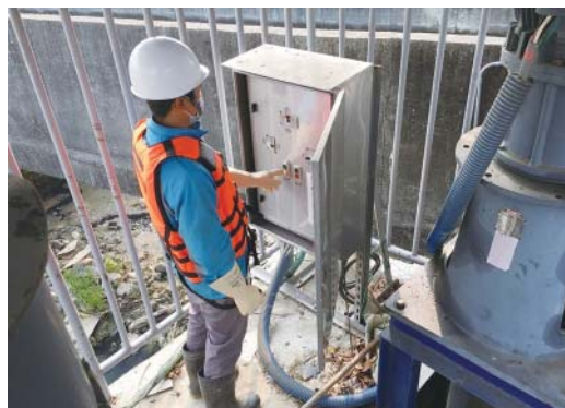
抽水機操作人員機動調節抽水機
