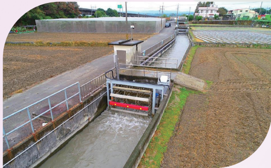
雲林管理處林內圳(0k+200)微水力發電站(設置容量20kW)
