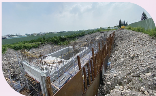
雲林管理處鹿場課圳第一、二、三號跌水工小水力案場(規劃設置容量475kW)
