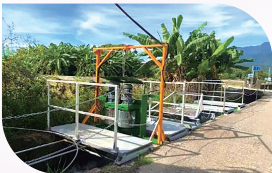
花蓮管理處吉安圳1幹線2支線2分線微水力發電站(設置容量1.5kW)
