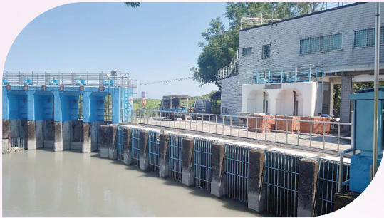
宜蘭管理處萬長春圳小水力發電設備案場(規劃設置容量252kW)
