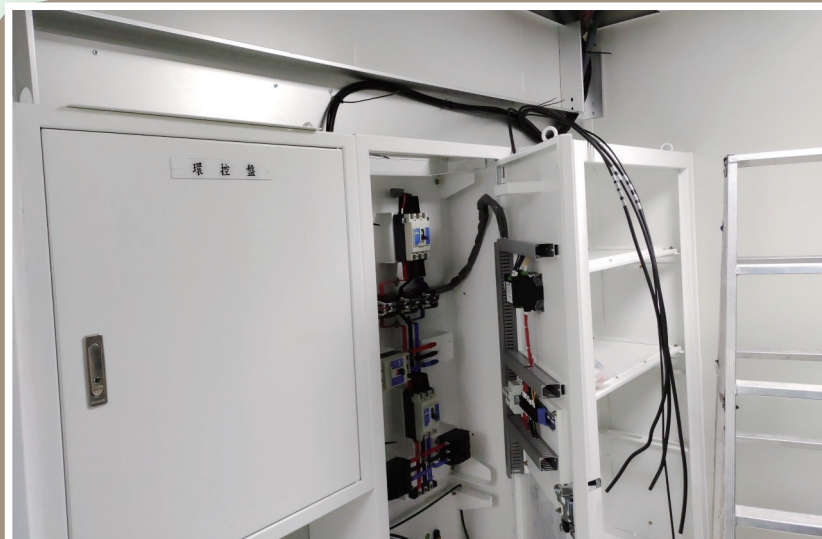
| 圖1、獨立配電源箱
